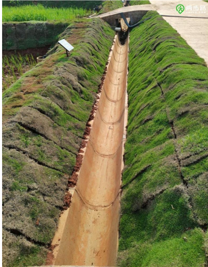
图 6 海口市琼山区三门坡镇铁炉土地整治项目排水设施照片示例
