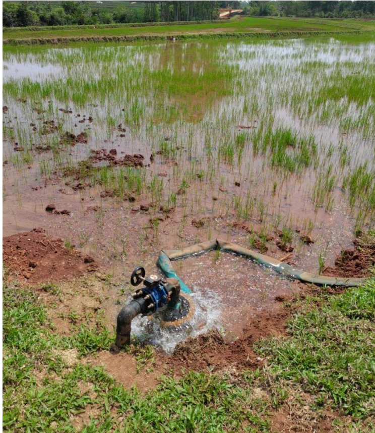
图5 海口市琼山区三门坡镇铁炉土地整治项目灌溉设施照片示例
